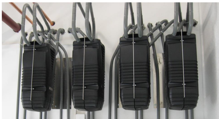
VULCAN suodattimet asennettu vastakkain
